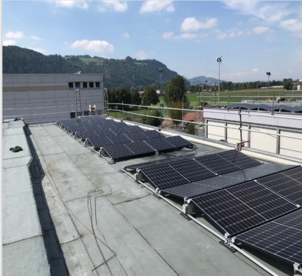
Neue PV-Anlage auf Turnhallendach
