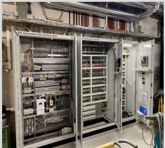
Neue Elektro- und Steuerungsanlage
