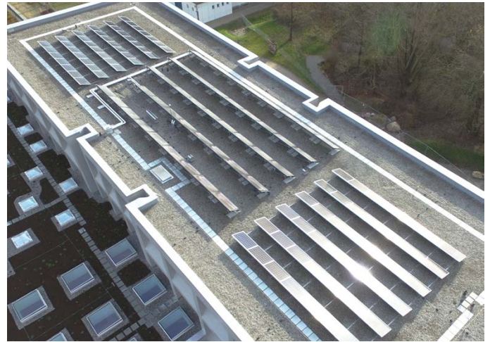
41 Die Photovoltaik-Anlage auf dem Schulhaus Schwerzgrueb lieferte 2023/24 insgesamt 20 120 kWh Strom.
