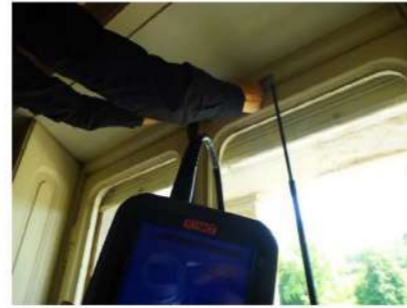
N.6 Perdita telaio apribile in corrispondenza del traverso superiore – Valore perdita: 4,30 m/s
