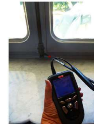
N.3 Perdita telaio apribile in corrispondenza del sistema di chiusura in mezzera – Valore perdita: 0,16 m/s
