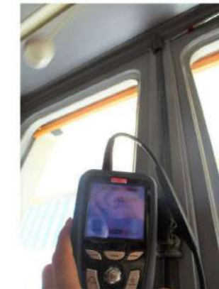
N.4 Perdita telaio apribile in corrispondenza del sistema di chiusura in mezzera – Valore perdita: 0,96 m/s
