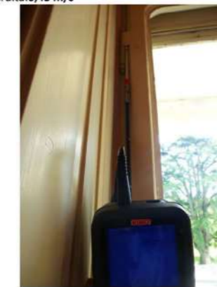
N.13 Perdita telaio apribile in corrispondenza della cerniera superiore – Lato sx – Valore perdita: 2,79 m/s
