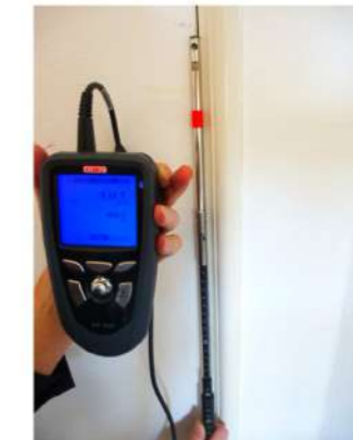
N.4 Perdita in corrispondenza della canalina porta impianto – Valore perdita: 1,21 m/s
