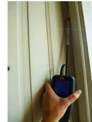
N.3 Perdita telaio apribile in corrispondenza della cerniera superiore – Lato sx – Valore perdita: 1,76 m/s
