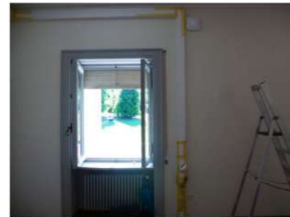
Fig.6 Sigillatura della canalina porta impianto elettrico in corrispondenza delle giunzioni di ogni coperchio di chiusura e dei terminali
