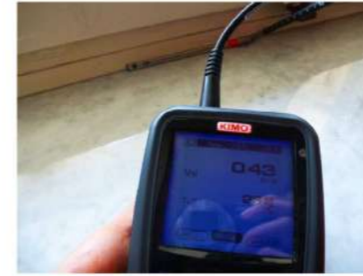
N.11 Perdita in corrispondenza del raccordo tra davanzale e traverso inferiore del serramento – Valore perdita: 0,43 m/s
