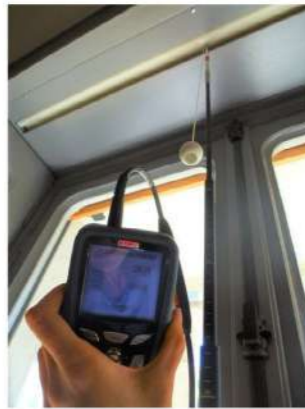
N.5 Perdita vano alloggio tenda a rullo – Valore perdita: 3,3 m/s
