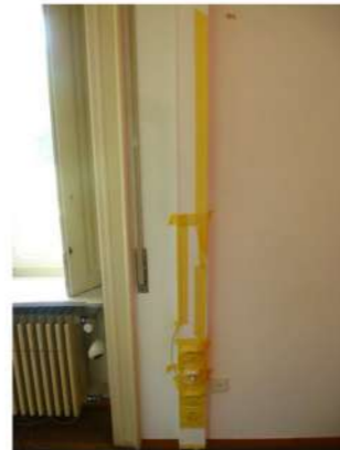
Fig.6 Sigillatura della canalina porta impianto elettrico in corrispondenza delle giunzioni di ogni coperchio di chiusura e dei terminali
