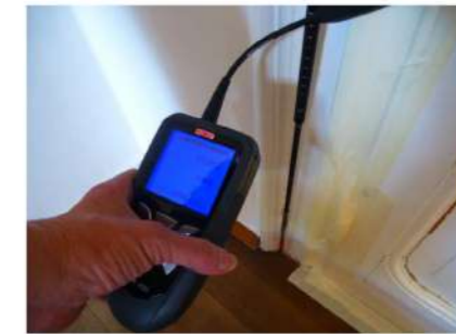
N.2 Perdita in corrispondenza della cornice della porta interna - Lato sx – Valore perdita: 2,96 m/s
