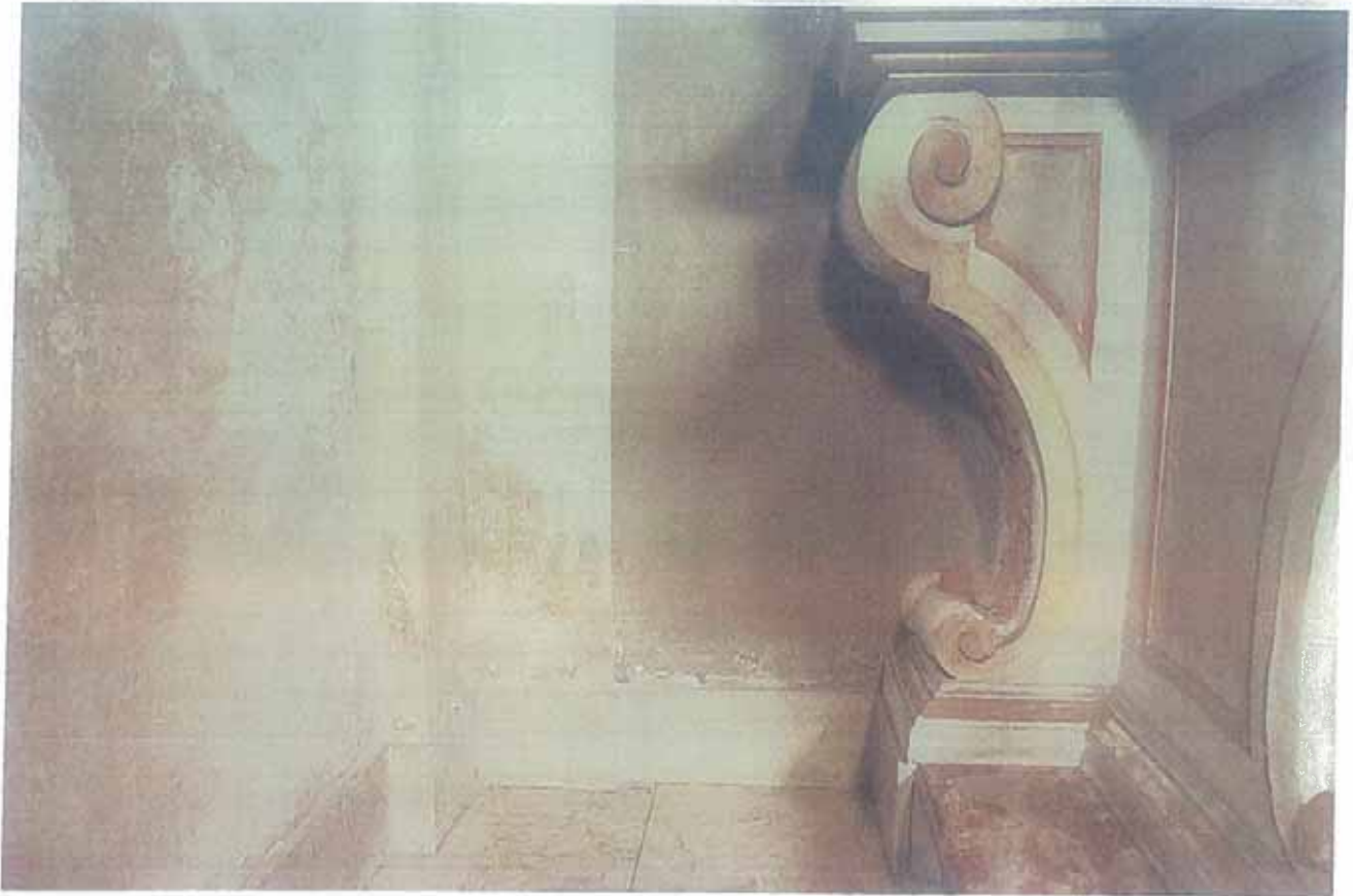
CAPPELLA DEL ROSARIO, ANGOLO NORD-OVEST, PARTICOLARE DELLO ZOCCOLO Nella foto è evidente il degrado dovuto all'umidità di risalita.
