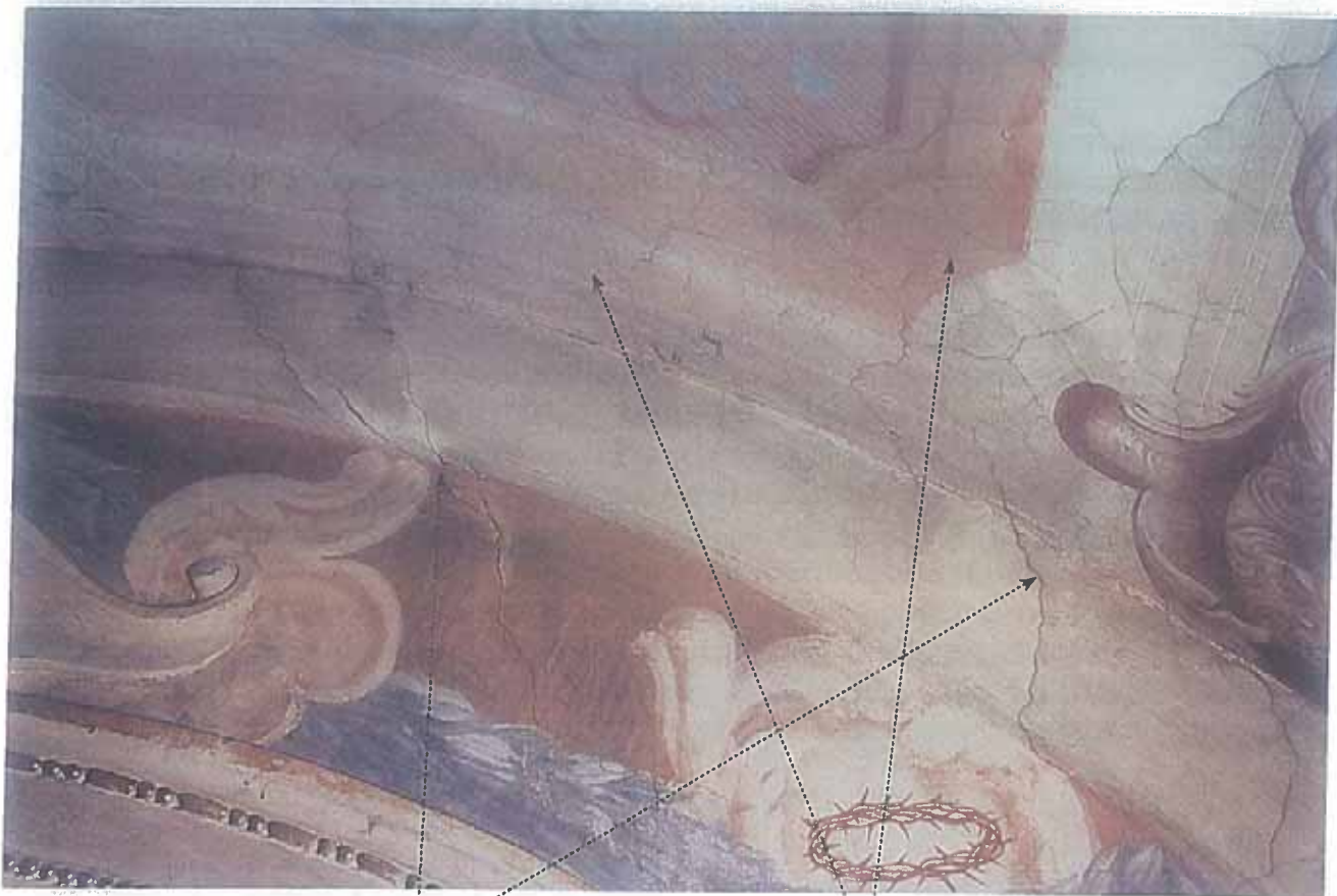
FIG. 3 - NAVATA, ARCO TRIONFALE LATO DESTRO La foto evidenzia le lesioni strutturali e le crettature relative al solo intonaco
