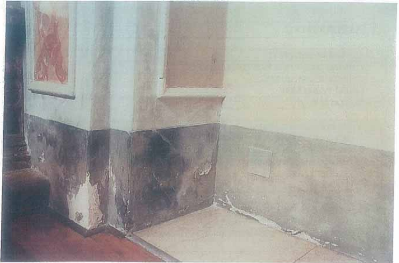
NAVATA, PARETE NORD, PARTICOLARE DELLO ZOCCOLO Nella foto è evidente il degrado dovuto all'umidità di risalita.
