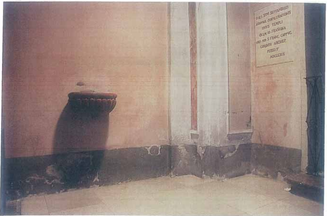
NAVATA, ANGOLO NORD-OVEST, PARTICOLARE DELLO ZOCCOLO Nella foto è evidente il degrado dovuto all'umidità di risalita.
