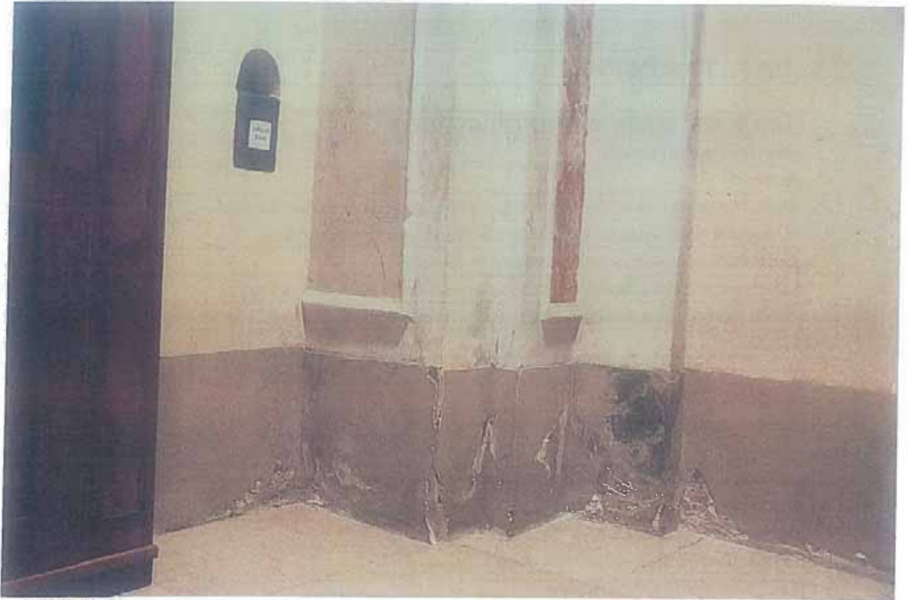
NAVATA, ANGOLO NORD-EST, PARTICOLARE DELLO ZOCCOLO Nella foto è evidente il degrado dovuto all'umidità di risalita.
