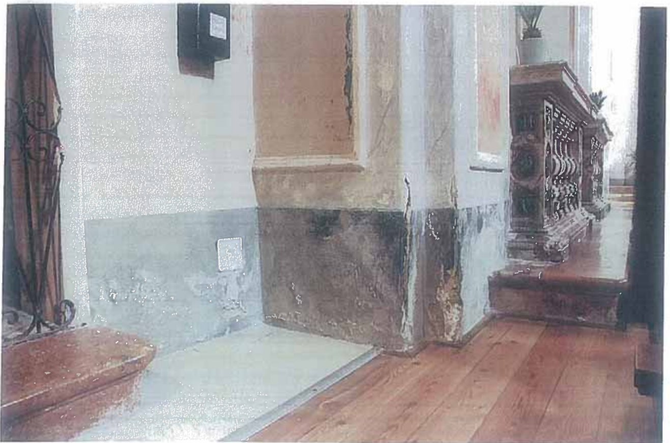
NAVATA, PARETE NORD, PARTICOLARE DELLO ZOCCOLO Nella foto è evidente il degrado dovuto all'umidità di risalita.
