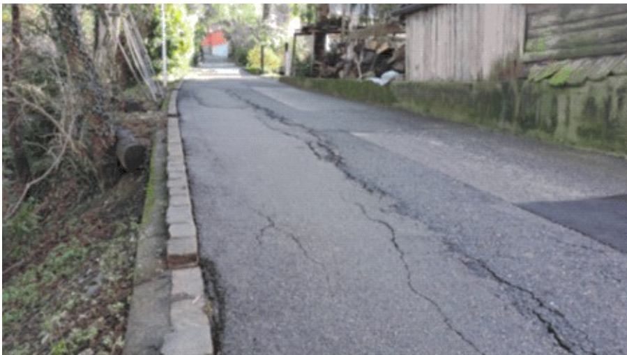
Fessurazioni e cedimento stradale
