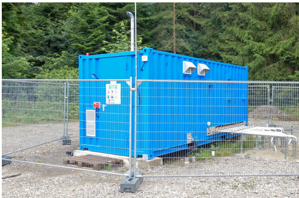
Aerobisierungsanlage in der ehemaligen Deponie Mellgenten.
