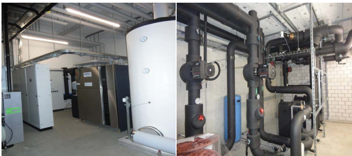
Installierte Wärmepumpe mit Wassererwärmer und Wärmetauscher im Staatsarchiv
