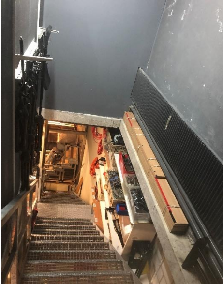
ABBILDUNG 16: FLUCHTWEG-GEFAHR, HERABFALLENDE GEGENSTÄNDE
