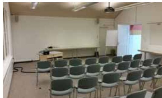
Schulungsraum veraltete Technik / offene Kabelführungen
