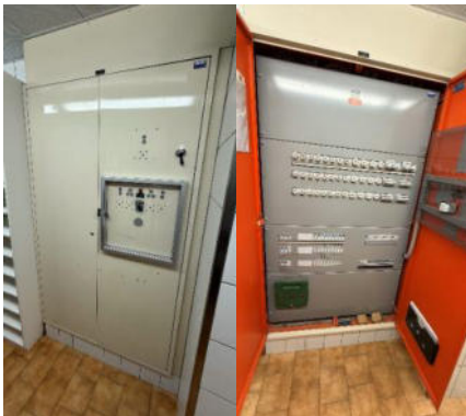
Bilder 11 UV Office (Sanierungsbedarf)
