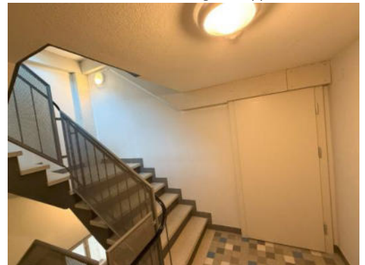
Bild 19 Brandschutzverkleidung im Treppenhaus
