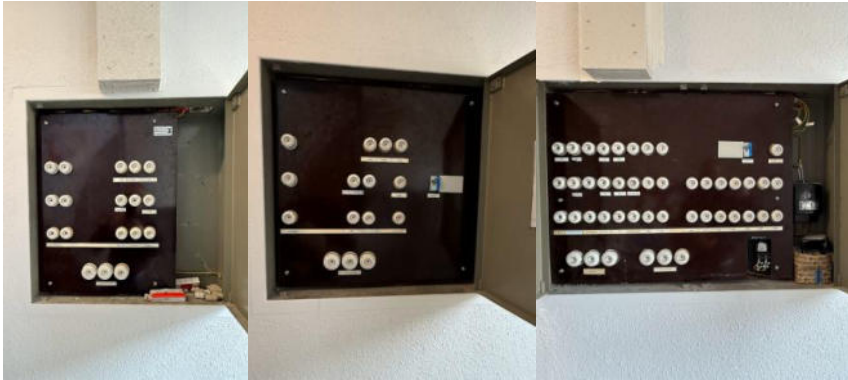
Bilder 8 UV's 2.-4.OG Treppenhause (Sanierungsbedarf)
