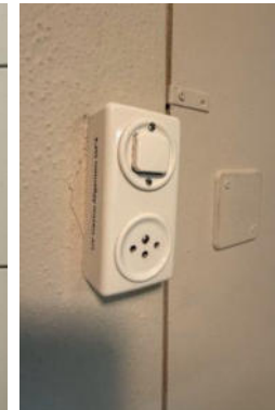
Bild 22 Steckdose ohne Schutzkragen
