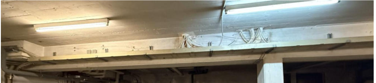
Bild 16 Trasse in der Tiefgarage
