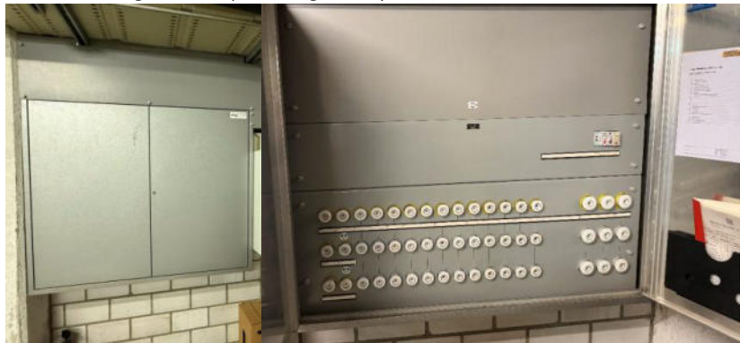
Bilder 10 UV Allgemein UG (Sanierungsbedarf)
