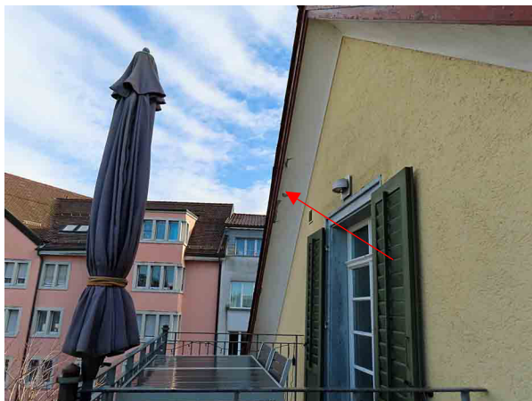
An der Nordfassade liegen an der Dachuntersicht Anstrich- und oberflächliche Verputzabplatzungen vor.
