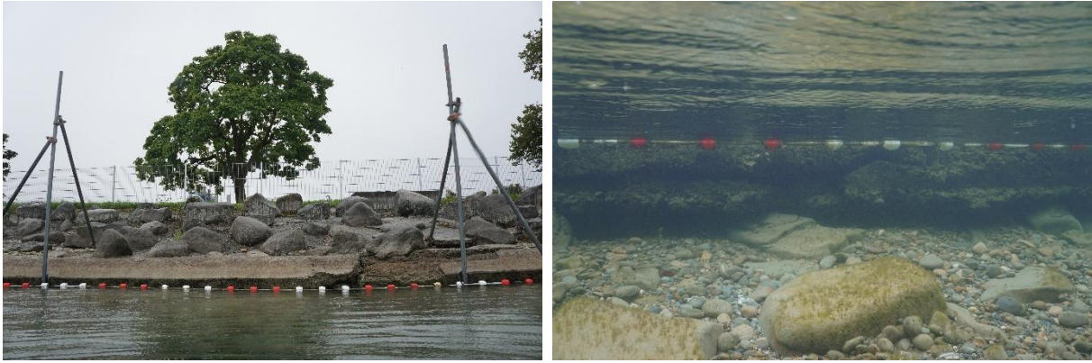
Abb. 8: Unterspülter Uferverbau aus Beton und Blöcken bei Transekt C.
