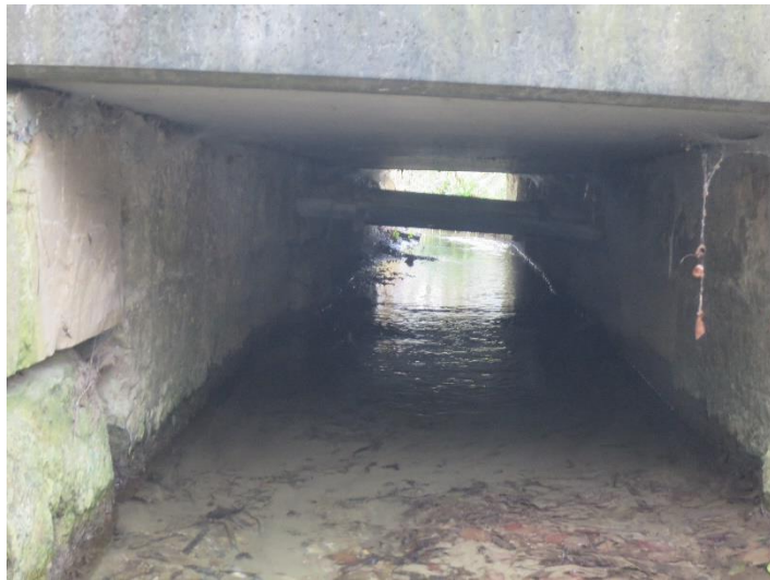
Abbildung 24: Durchlass Hottigergasse mit tiefliegender Werkleitung.
