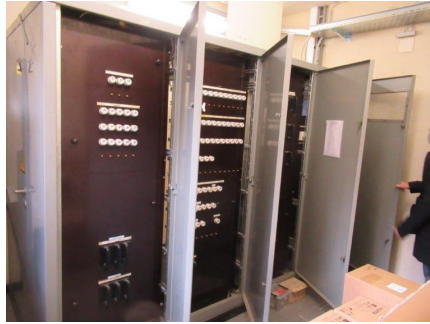
4.14 Elektrohauptverteilung im UG
