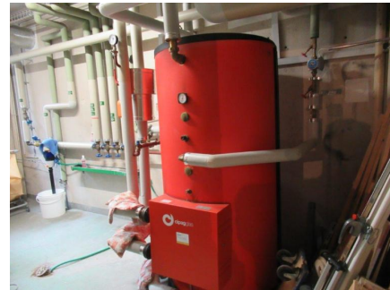
4.27 Warmwasserspeicher im UG
