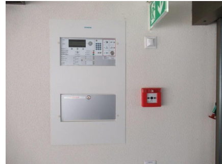
4.19 Tableau Brandmeldeanlage beim Seiteneingang
