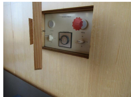
4.24 Bedienelement Lüftung Original im Rathaussaal
