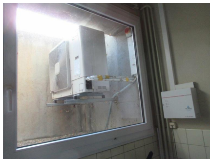
4.23 Kühlaggregat im UG für Serverräume
