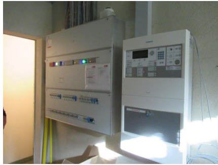
4.20 Brandmeldeanlage im UG
