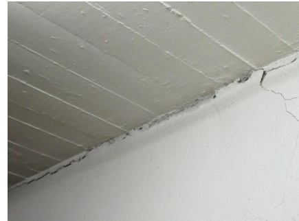
4.35 Risse in UG Wänden
