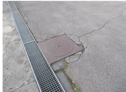
4.43 Risse und abgesenkte Stellen in Asphaltfläche zur A.Z.-Strasse hin
