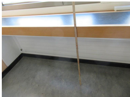
4.11 Fensterbrüstung im Erschliessungsbereich besteigbar
