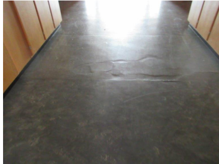
4.32 Originallinoleum mit Absenkungen im Flur
