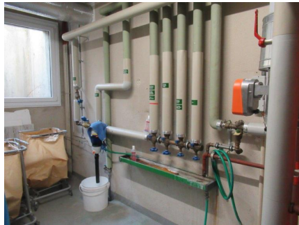
4.26 Sanitärhauptverteilung im UG
