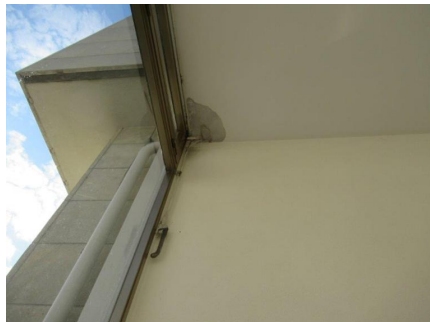
4.36 Putzabplatzung bei Originalverglasung Seiteneingang
