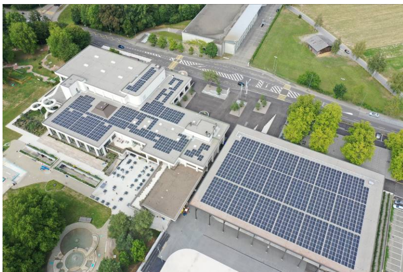
Abbildung 11: Photovoltaik-Anlage auf dem Dach
