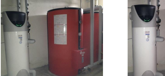
Die neuen Boiler mit der Wärmerückgewinnung.
