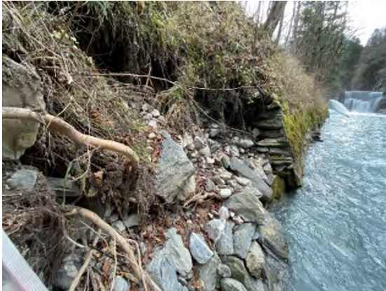
Ausgespülte Wuhrmauer km 3.6
