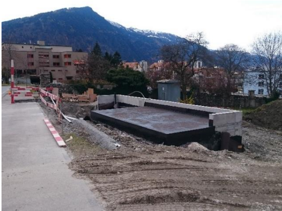
Neue Trafostation der IBC
