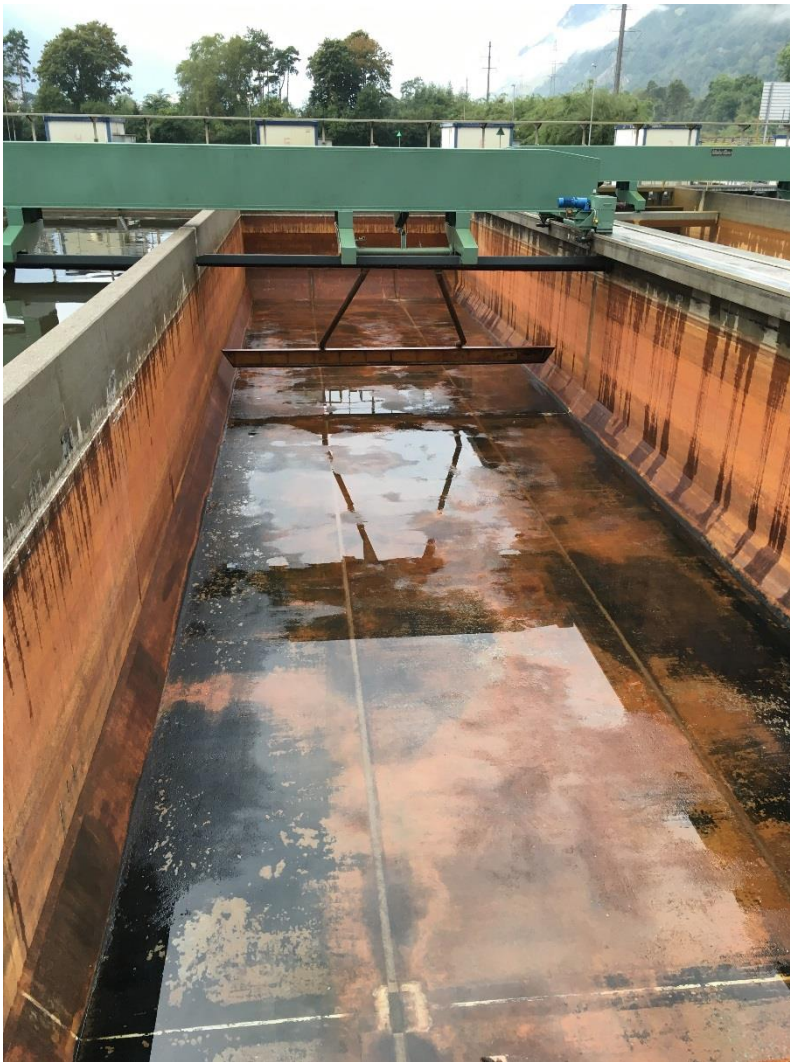
Komplett entleerte Reinigungsstrasse
