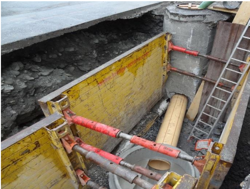
Bestehender Kanalisationsschacht mit Verbindung zu neuem Bodenelement/Kontrollschacht
