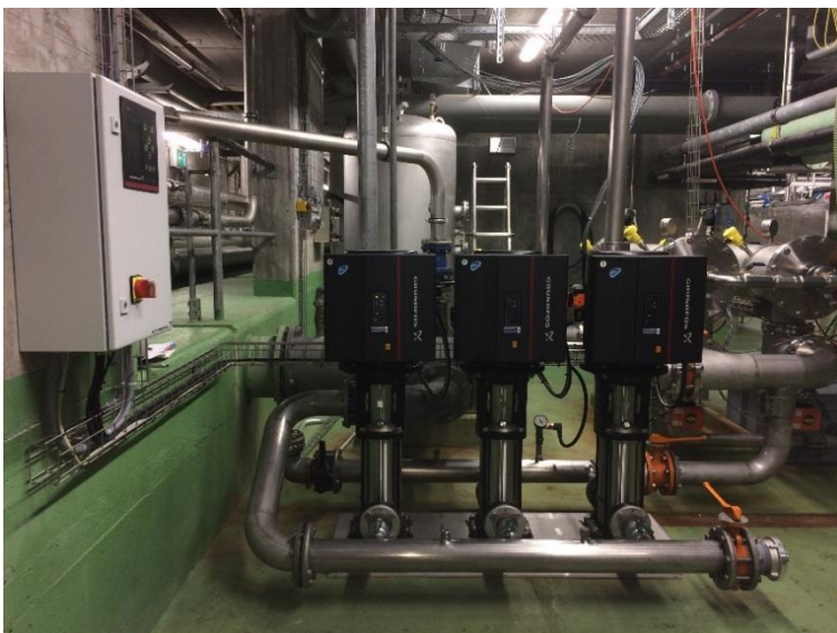
Erneuerte, moderne Druckerhöhungsanlage
