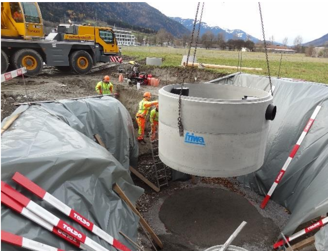
Ölabscheider vorgelagert dem Sickerschacht
