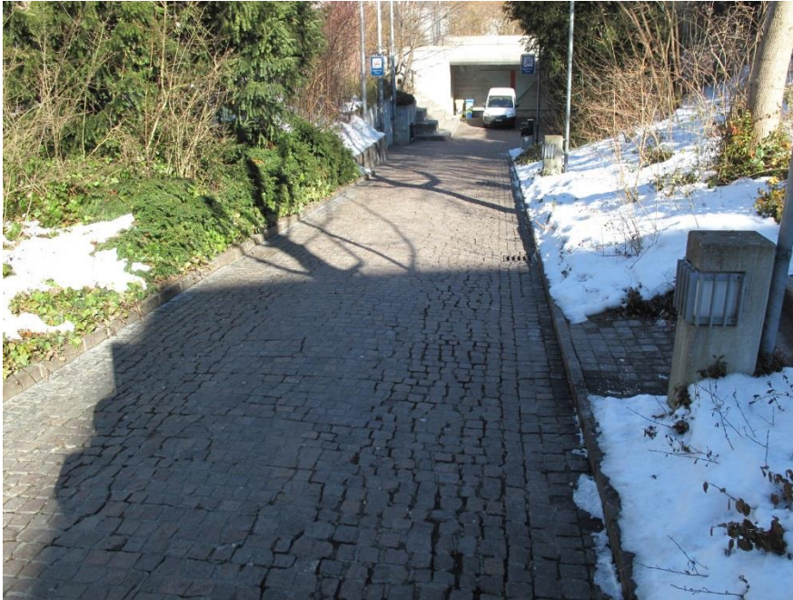
Turnhallenzugang mit defekter und loser Porphyr-Pflasterung vor der Sanierung
