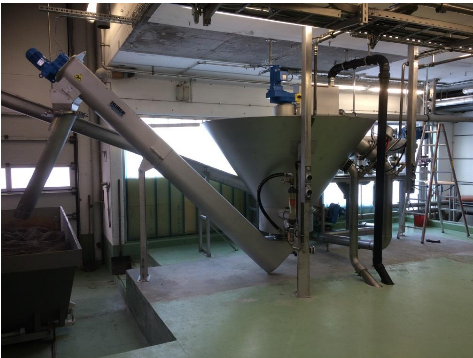
Die erneuerte Sandwaschanlage im Rechengebäude
