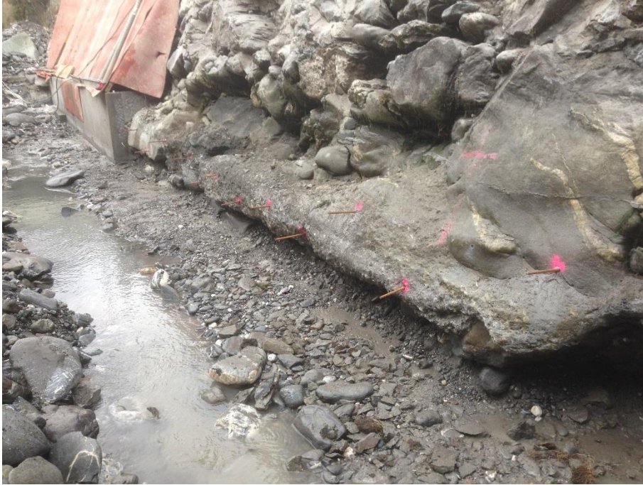
Das unterspülte Wuhr bei Sanierungsbeginn
