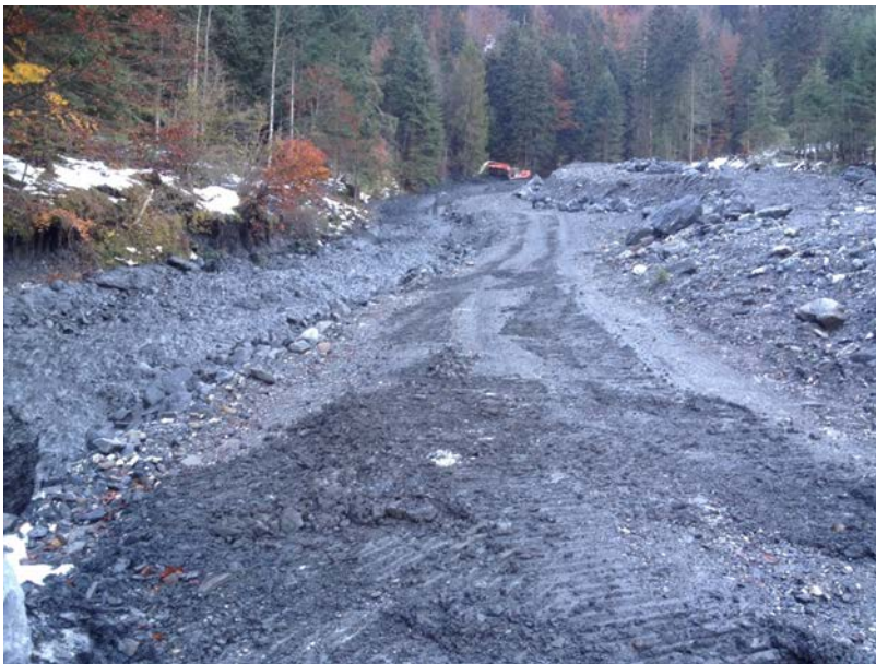
Aufgefüllter Bachlauf des Valpargheratobels nach einem Riefenniedergang.
