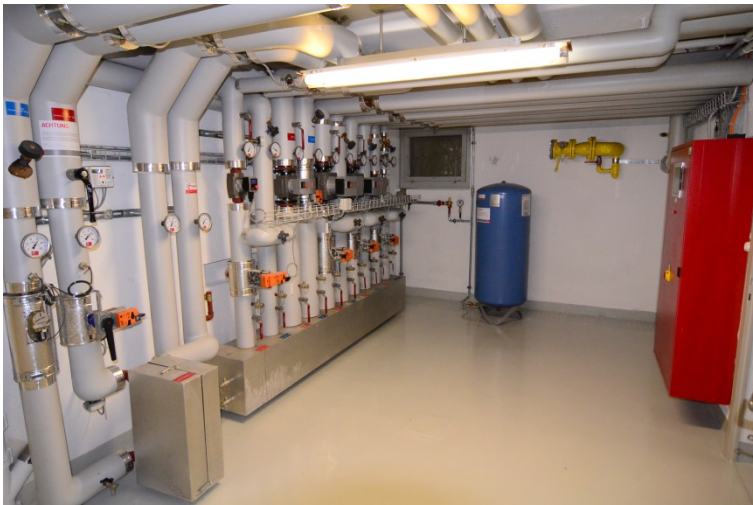
Heizungsverteilung Schulhaus Montalin.
