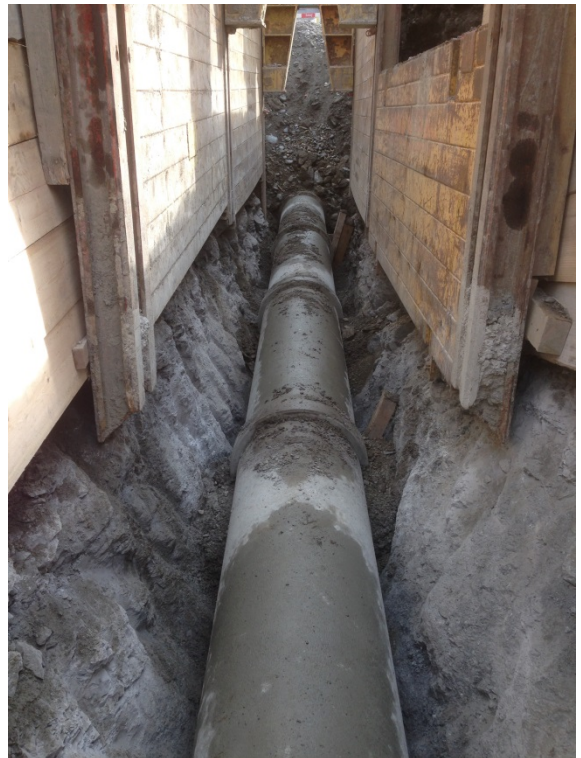
Kanalisationsleitung mit Durchmesser 500 mm.
