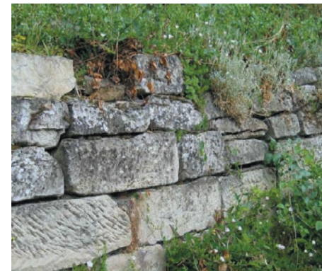
Bruchsteinmauer mit Bewuchs
