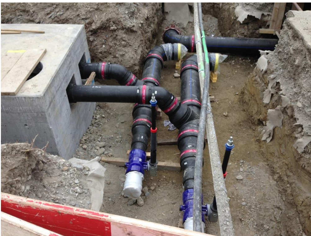
Anergieschacht mit Vor- und Rücklaufleitung
