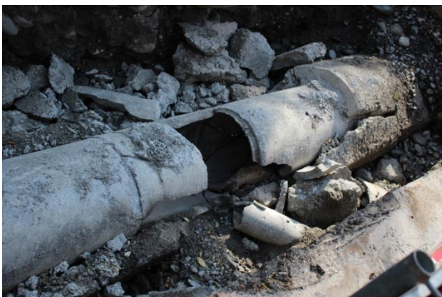
Der eingebrochene Betonkanal
