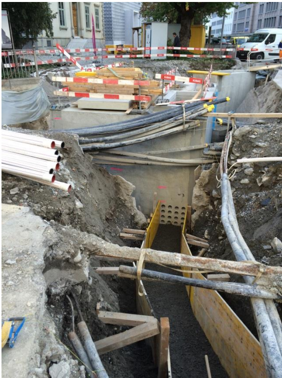
Kabelblock für EW-Trasse
