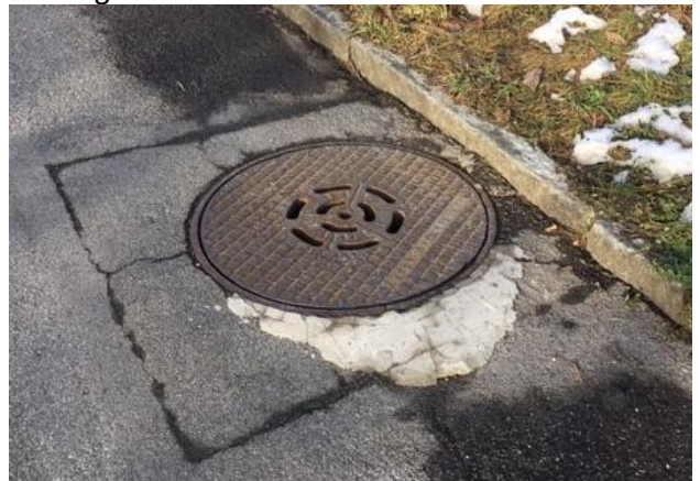
Abb. 5 Schachtdeckel mit Reparaturstelle
