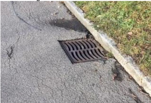
Abb. 4 Senkungen bei Einlaufschächten
