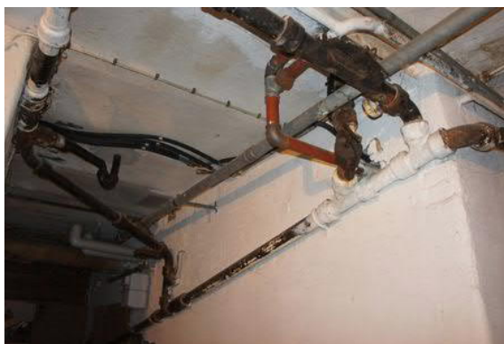
Wasser- und Abwasserinstallationen
