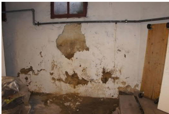
Abplatzungen infolge Feuchtigkeitseindringung
