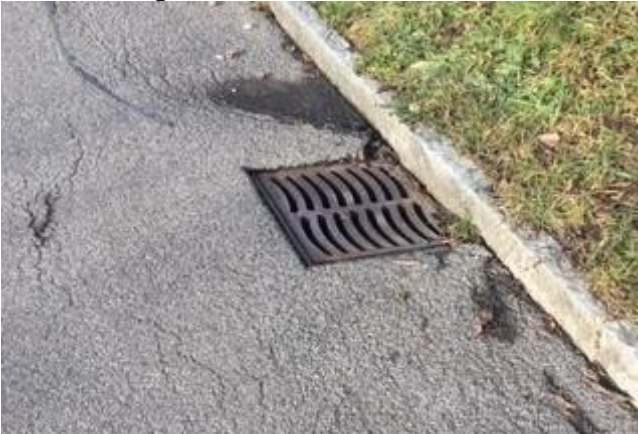
Abb. 4 Senkungen bei Einlaufschächten
