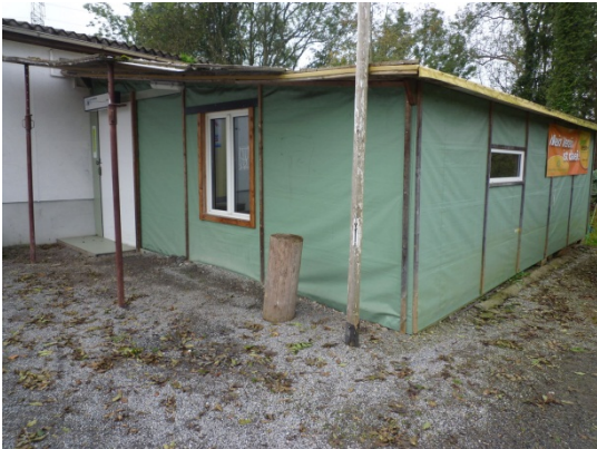
Schiessanlage Espel (defektes Vordach)
