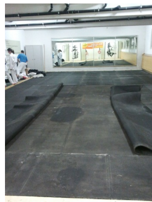
Dojo: feuchter Unterboden
