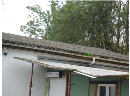
Schiessanlage Espel (defektes Vordach)
