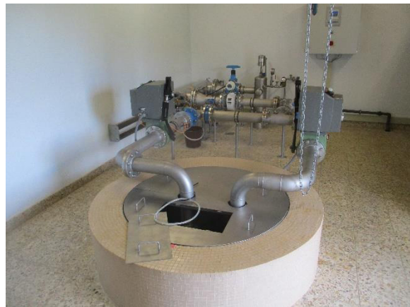
Abb. 4.2: Fassungsschacht und Installationen (Foto L&H 18.6.2020)
