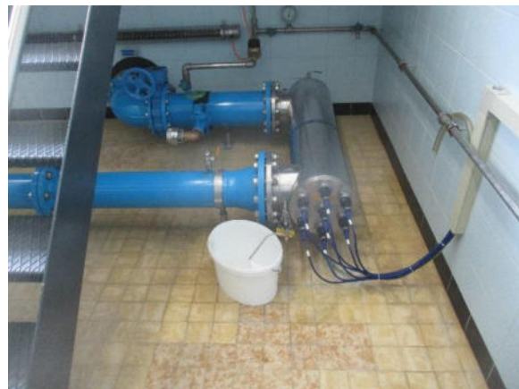
Abb. 4.4: UV-Anlage (Foto L&H 18.6.2020)
