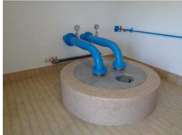
Abb. 4.2: Fassungsschacht (Foto L&H 18.6.2020)
