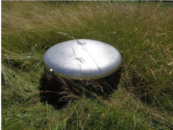
Abb. 4.6: Sickerschacht (Foto L&amp;H 18.6.2020)
