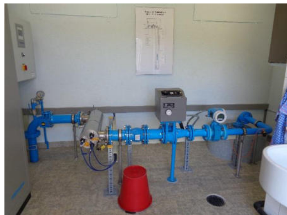
Abb. 4.2: Fassungsschacht (rechts) und Installationen (z.B. UV-Anlage) (Foto L&H 18.6.2020)
