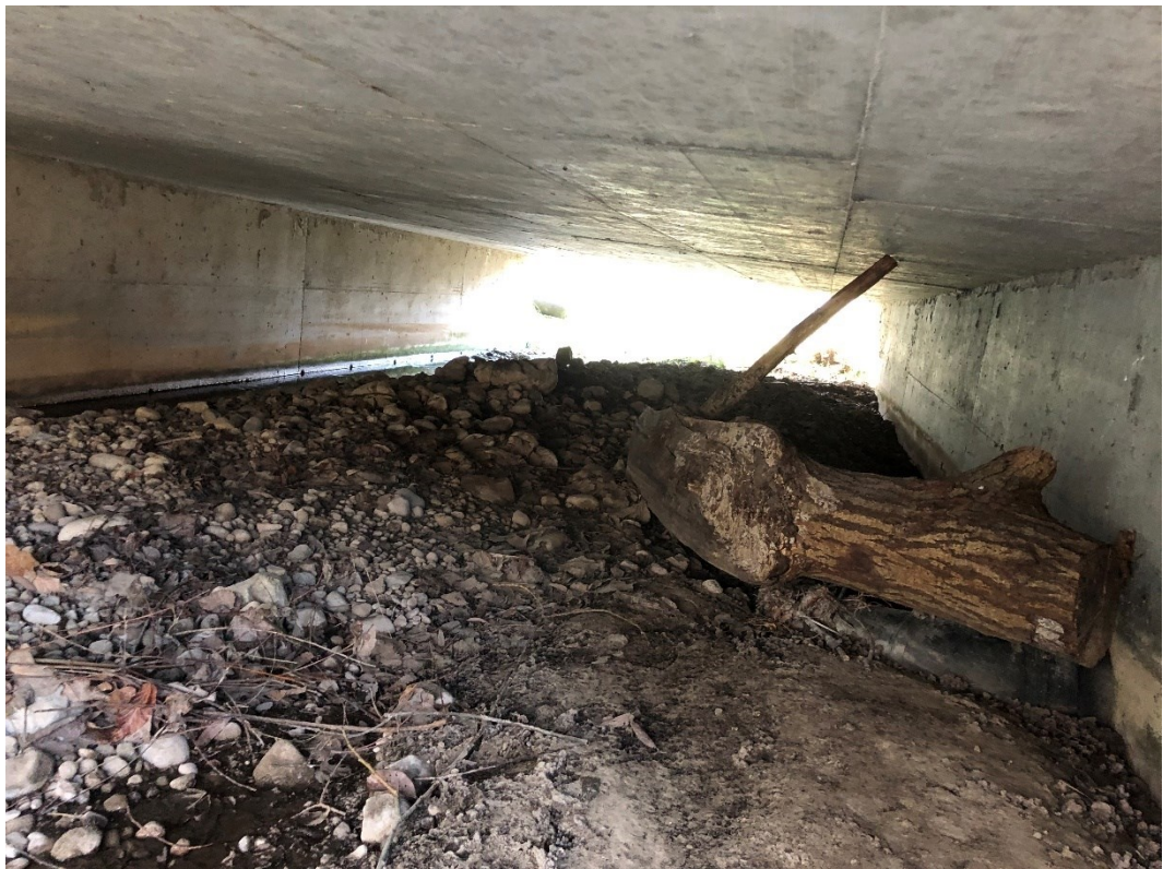
Abbildung 4: abgelagertes Schwemmholz unter der Brücke Tiefgaragenzufahrt (Foto: M+P)
