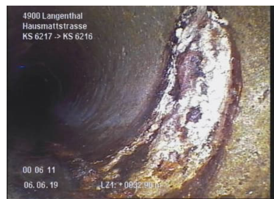
Abbildung 6: Rohrwandung stark verkalkt
