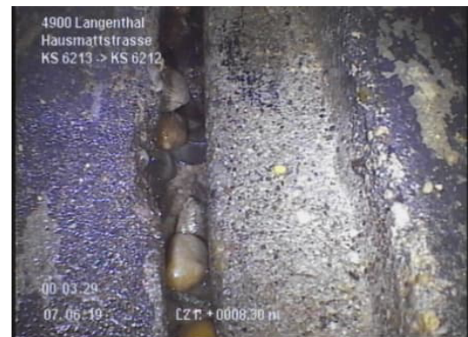
Abbildung 8: Muffe stark versetzt und geöffnet
