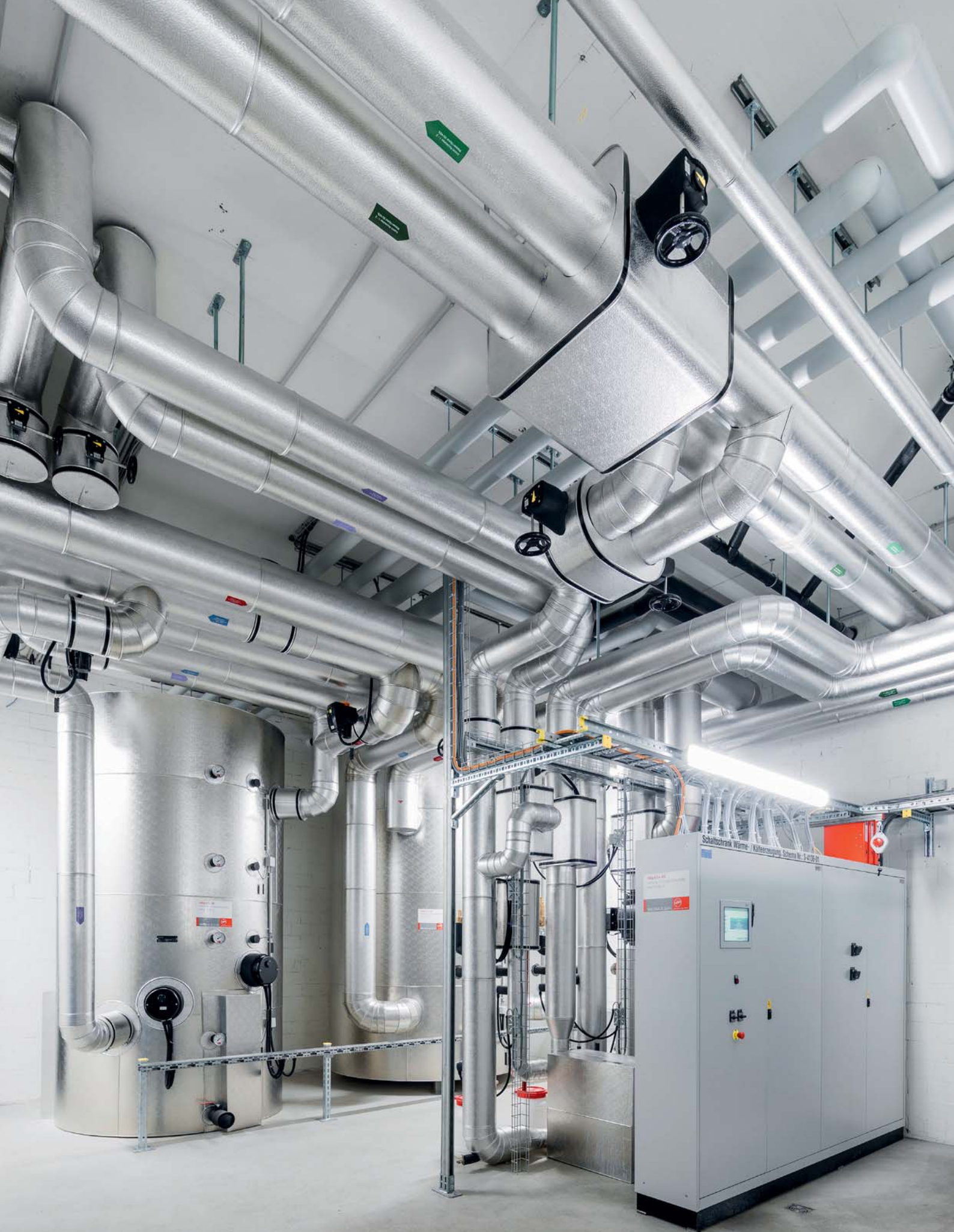
Die neue Energiezentrale der City-Garage versorgt das Gebäude mit umweltverträglich produzierter Wärme und Kälte.
