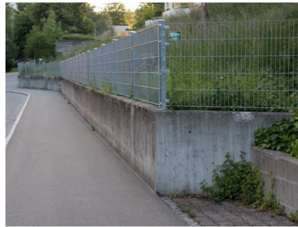
Abb. 25: Liegenschaften am Hang sorgen vielfach mit Stützmauern, Treppen und Zäunen für viele Barrieren.
