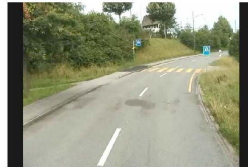
1 | 5 Keine Beleuchtung, keine Mittelinsel: Dieser Fussgängerstreifen in Illnau gehörte zu den schlechtesten auf Zürcher Staatsstrassen. Bild: Baudirektion des Kantons Zürich (5 Bilder)
