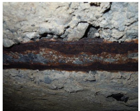
bauliche Mängel, Zivilschutz-Standort Usterstrasse
