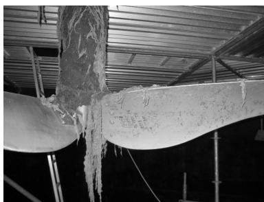
Verzopfungen am unteren Rührwerk
