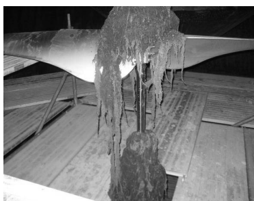
Verzopfungen am oberen Rührwerk
