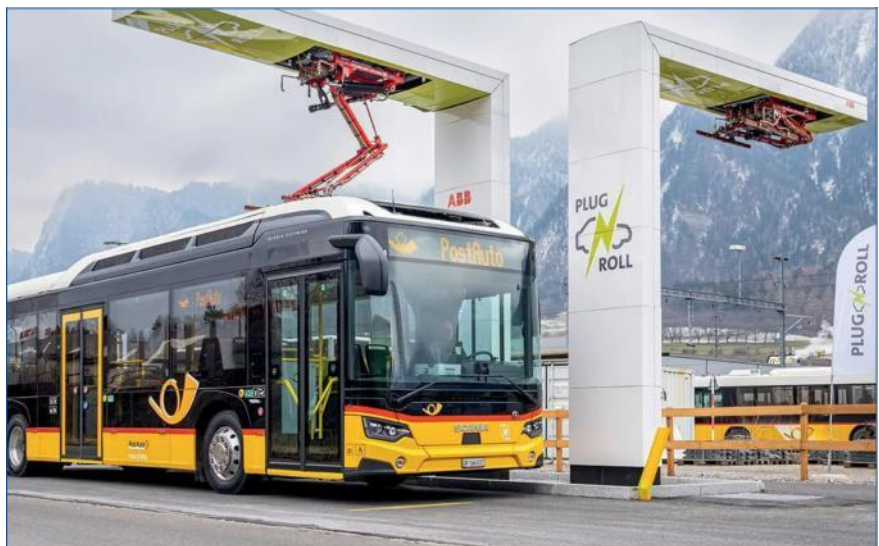
Abb. 12: Schnell-Ladestation für Postauto-Busbetrieb in Graubünden (Quelle: Repower)
