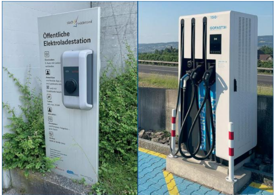
Abb. 10/11: Öffentliche Ladestation beim Hallenbad mit 1 Ladepunkt (22 kW/ AC) und Schnell-Ladestationen an der Autobahn in Horgen (je 150 kW/ DC)
