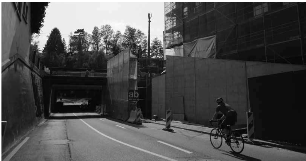
Oristalunterführung: Der hintere Teil der Betonmauer rechts im Bild wird Träger der neuen Brücke sein.
