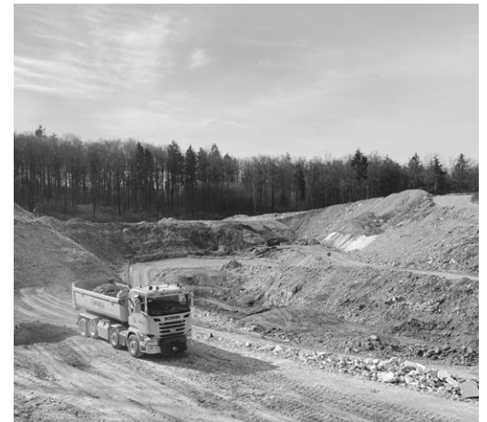
Deponie Höli: seit Mitte März wieder befahren
