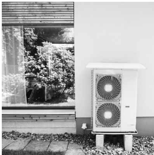
Wärmepumpe, Holzpellets und Solarthermie
