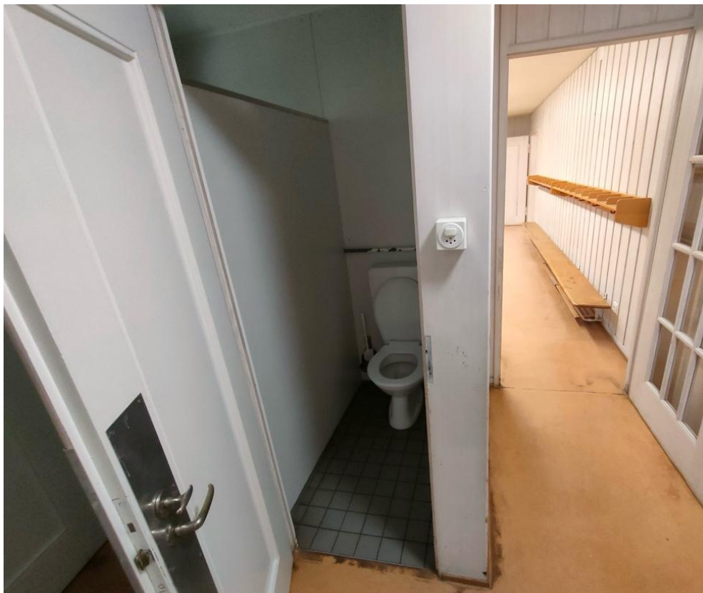
Nasszellen: 2 WC- Kabinen zu 1 IV-WC umbauen. Ein Waschtisch für die verbliebene 2 WC- Kabinen einbauen, da keinen vorhanden
