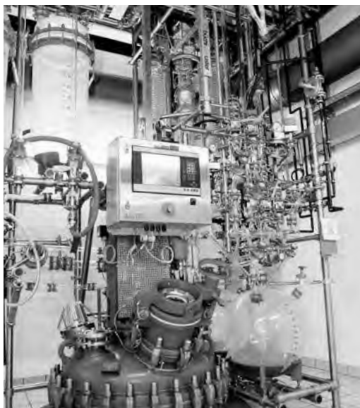
Produktionsanlage der Chemischen Industrie, für welche Penta-Electric die gesamte Elektro- und Steuerungseinrichtungen konzipiert und ausgeführt hat.
