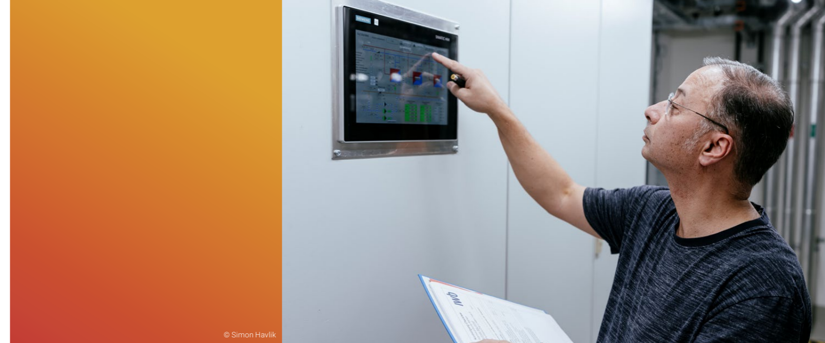
Der Betriebsleiter Nunzio Galvagno kontrolliert die Betriebsdaten der neuen Bäumlihof-Zentrale.
