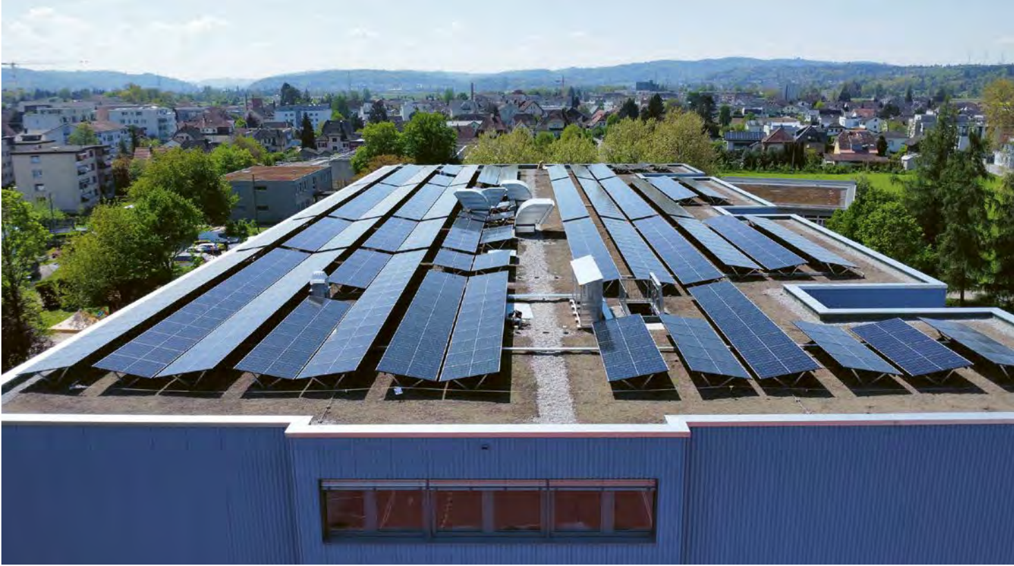
600 Solarpanels auf dem Dach des Oberstufenzentrums
