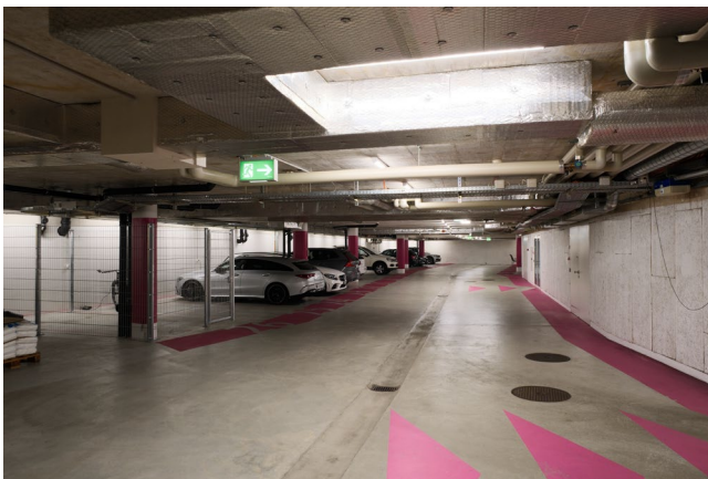
Tiefgarage, Leitungsführung zu Technikraum
