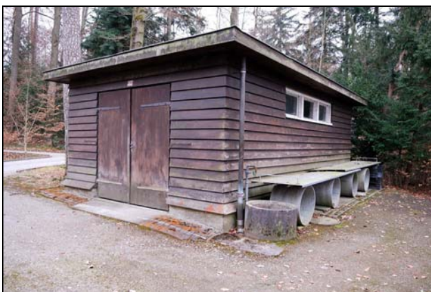
Werkzeug und Geräteschopf im Waldbereich; Abbruch geplant.
