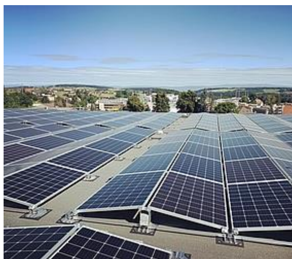
Image 1 : Installation solaire photovoltaïques sur le toit de la patinoire 1
