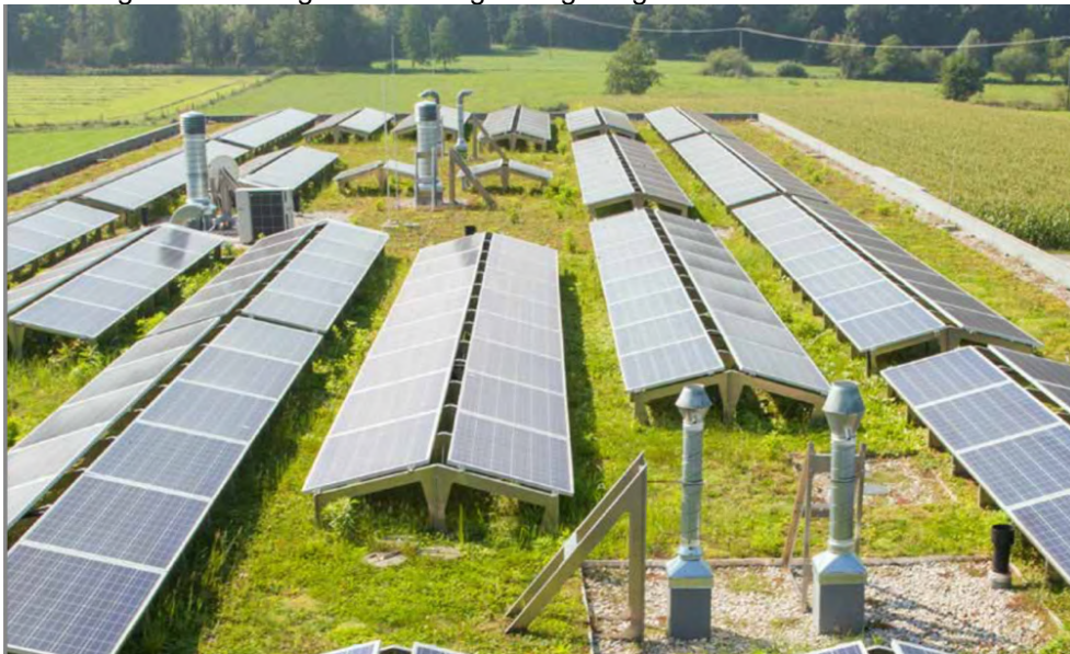
Abbildung 21: PV-Anlage in Dachbegrünung integriert
