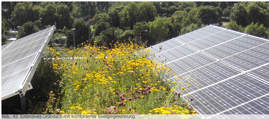
Abb.: 43 Extensives Gründach mit kombinierter Energiegewinnung
