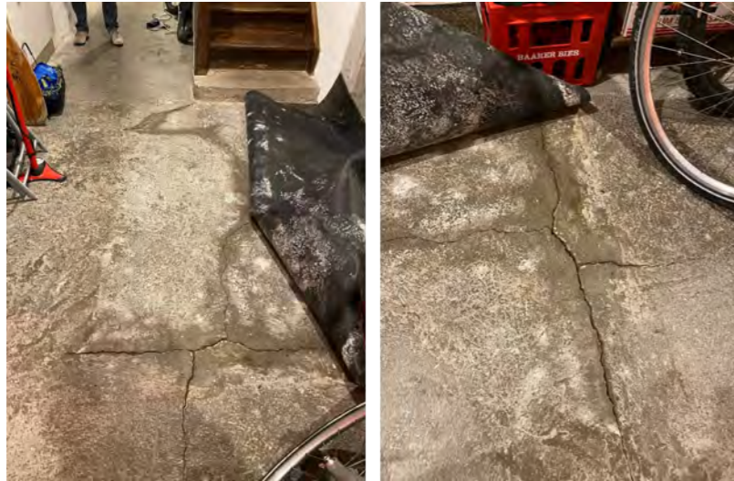
UG RISSE IN DER BODENPLATTE
