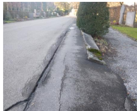
Durch die langjährige intensive Nutzung weisen die Beläge sämtlicher Wege des Friedhofs Friedental Risse und Abnützungen auf.
